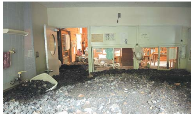
図8 宿泊棟の台所(2014年8月26日)。高さ1mほどの砂礫が堆積している
