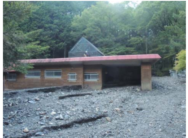
図7 宿泊棟の正面(2014年8月26日)。玄関ドアが半分以上埋れている
